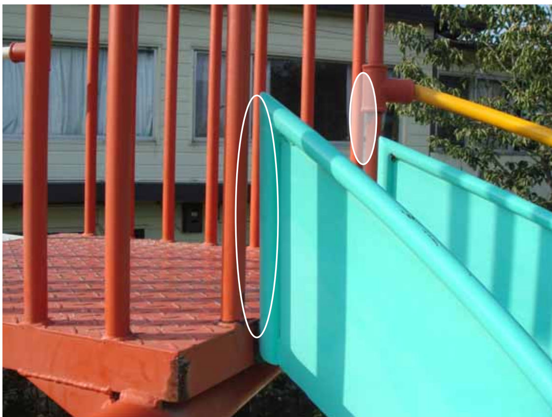
写真1 滑り出し部分の危険な隙間をなくす。
